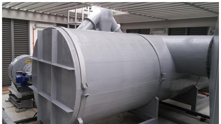
FRP Plenum Box
